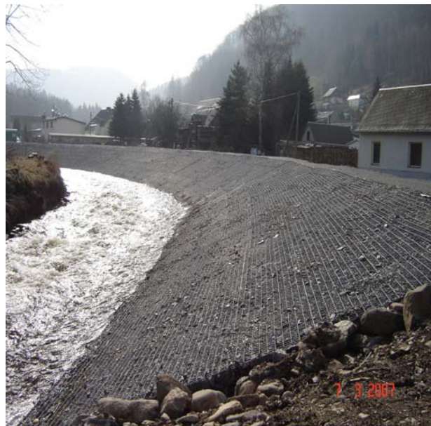
Abbildung 6: Deich mit Oberflächensicherung
