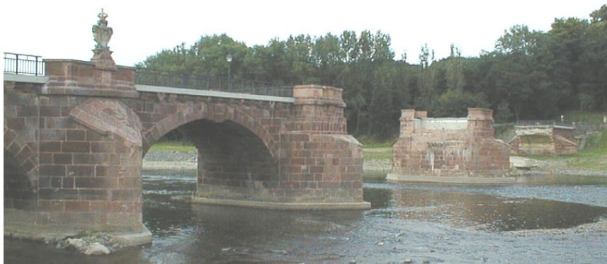
Abbildung 5: Zerstörte Muldebrücke in Grimma („Pöppelmannbrücke“) nach dem teilweisen Abbruch (Foto: Pohl 15.06.2003)
