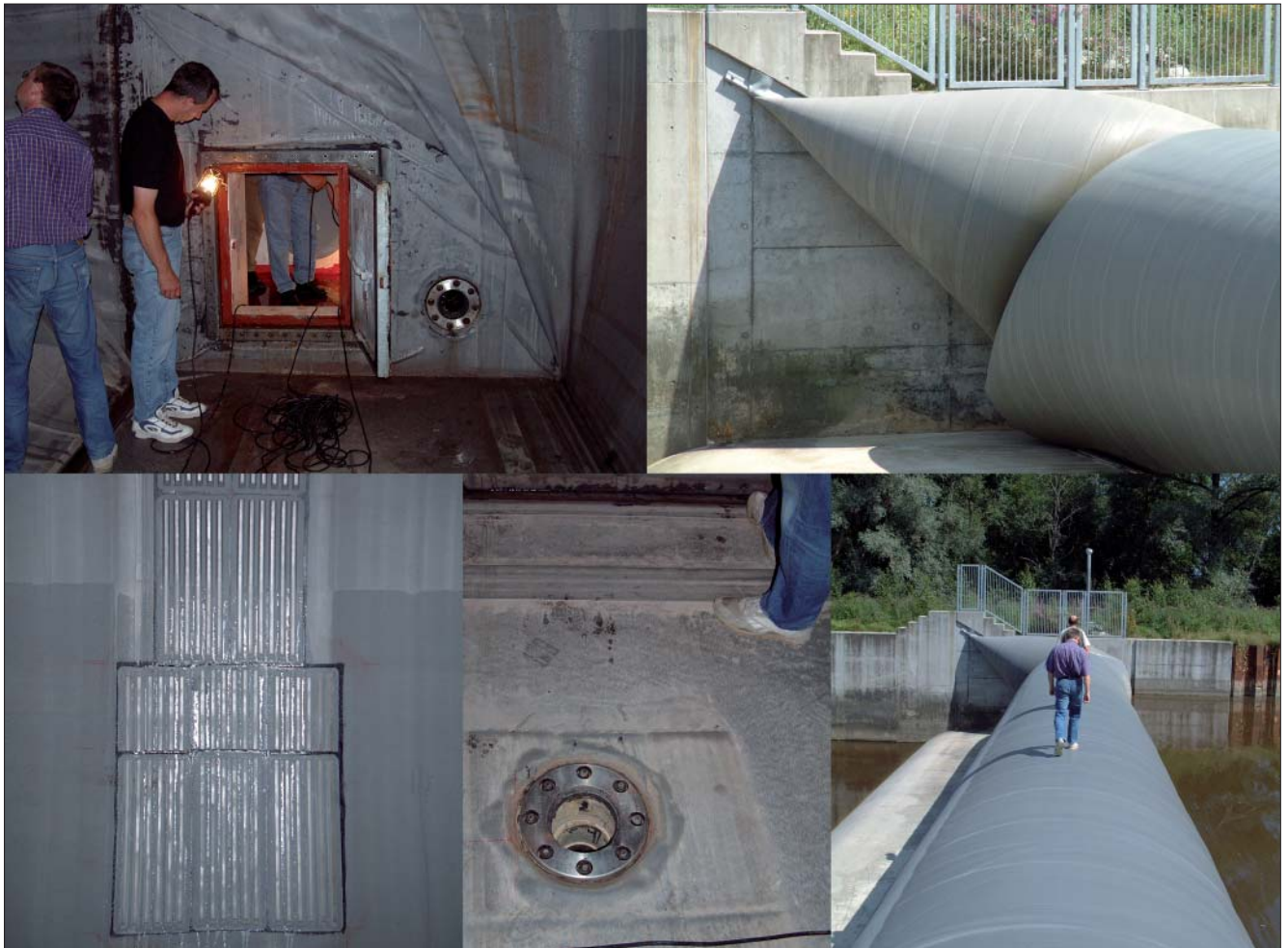
Bild 6: Schlauchwehr Türkheim an der Wertach: oben links) Druckschleuse an der rechten Wehrwange, oben rechts) seitlicher Anschluss, unten links) Sickermatten (engl. drain pads), unten Mitte) Ein- bzw. Auslassöffnung, unten rechts) Blick vom linken Ufer
