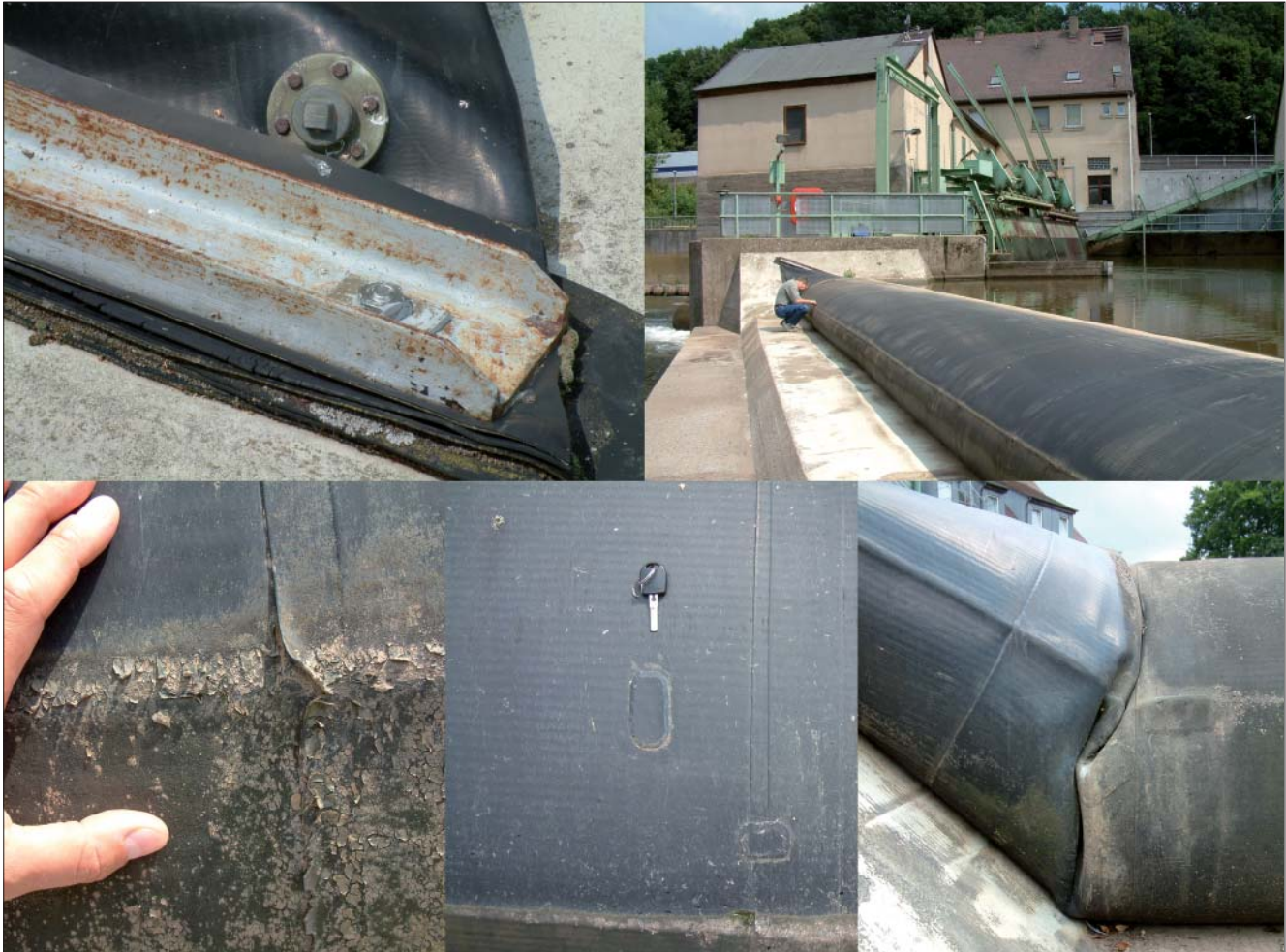
Bild 11: Schlauchwehr Erlangen an der Regnitz: oben links) seitliche Befestigung und Entlüftungsventil, oben rechts) Wehr mit Krafthaus, unten links) Membranoberfläche im Bereich der Knickstelle, unten Mitte) Reparaturflecken, unten rechts) Faltenausbildung an der Wehrwange
