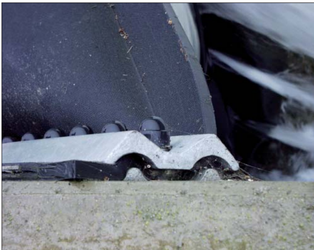
Bild 8: Schlauchwehr Kiebingen am Neckar: Klemmschiene an rechter Wehrwange
