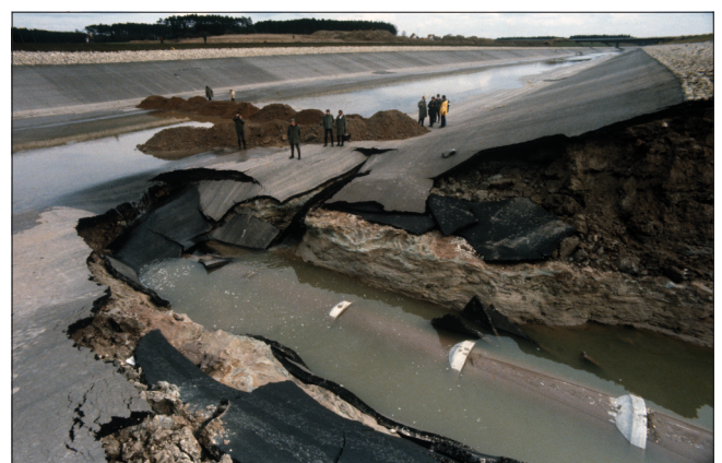
Bild 13: Beim Dambruch freigelegte Fernwasserversorgungsleitung (Quelle: Jürgen Gebhardt/Stern/Picture Press)
