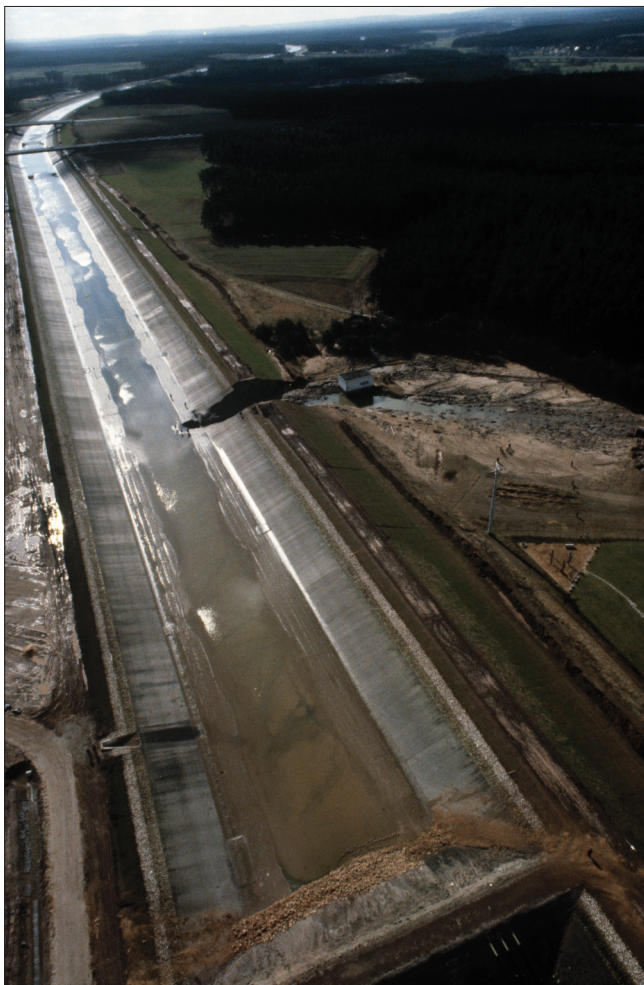
Bild 10: Leer gelaufener Abschnitt des MDK mit Dammbruchstelle (Quelle: Jürgen Gebhardt/Stern/Picture Press)
