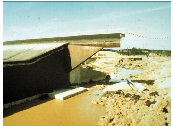
Bild 9: Seitlich des Tunnels weggespülter Damm (Quelle: Gutachten zur Schadensursache)
