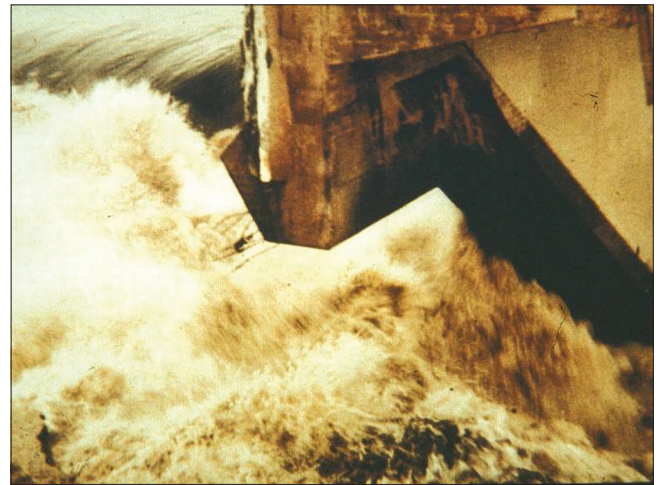
Bild 8: Unterspülung der Flügelwand (Quelle: Gutachten zur Schadensursache)
