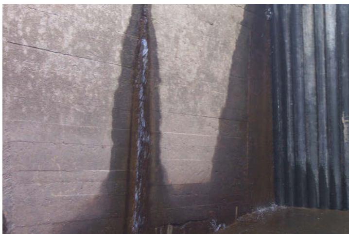
Schäden am Dehnungsfugenband
