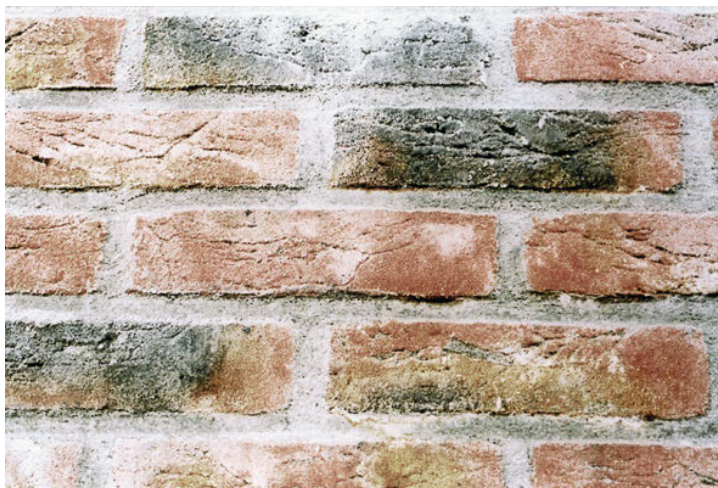
Steine (und Mörtelfugen) mit Ausblühungen
